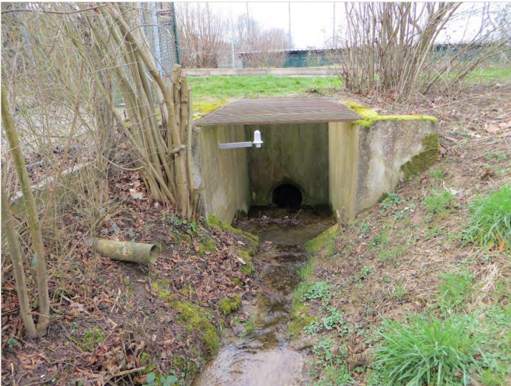
Einlauf Verdolung DN600 [Foto: N. Hahn]
